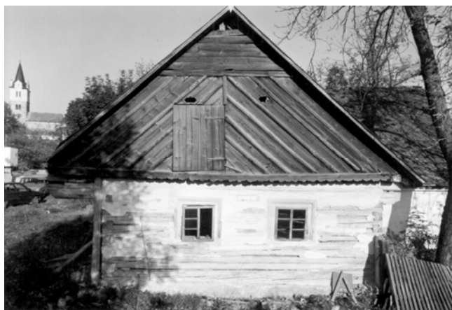
Obděnice čp. 4, stav před přenesením objektu do Muzea vesnických staveb (foto P. Dostál, 2000)
