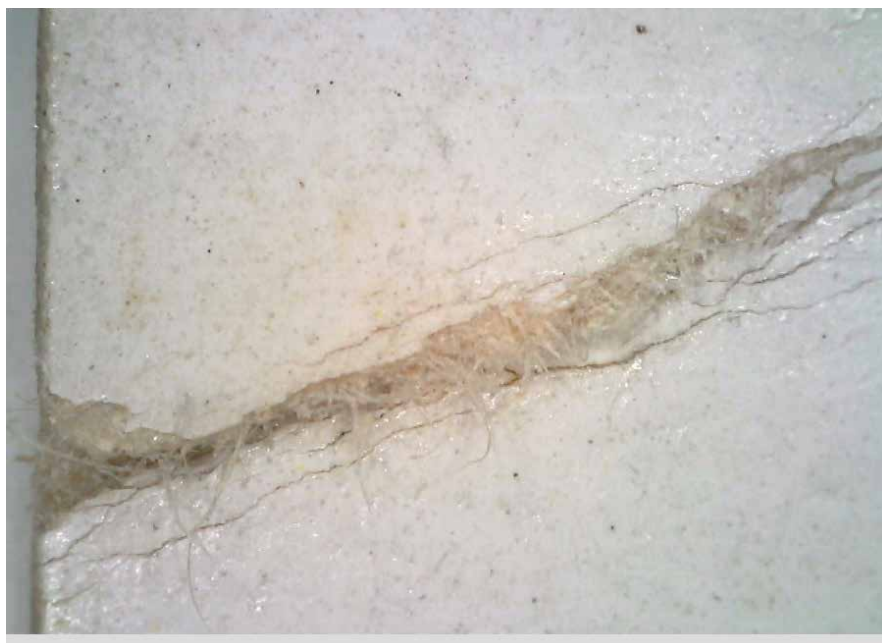
Trhlina s vlákny vystupujícími zpod minerální povrchové vrstvy, drobné praskliny v okolí
